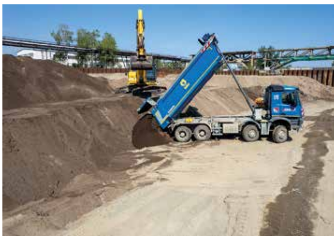
Insgesamt wurden 286.000 Tonnen mit Phenolen, PAKs und BTEX stark belastete Böden gereinigt.
