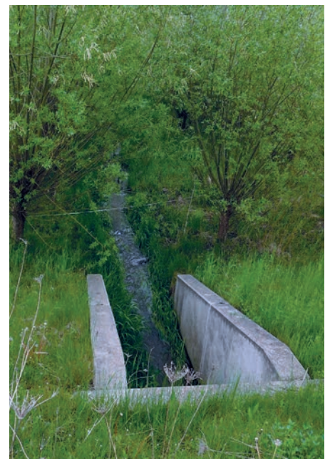
Temporärer Wasserrückhalt in Stadtgebiet Meerane (Foto: StadtLand GmbH)
