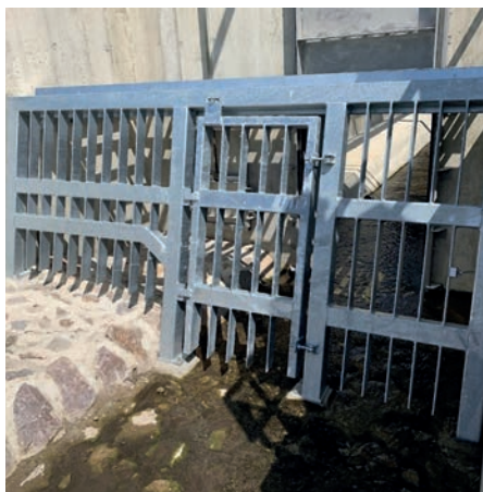
Grobrechen im Beckenraum
