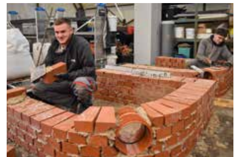
Paul Tründelberg (li.) und Tim Mugratsch mauern jeweils einen Schacht, wie dieser im Kanalbau oft erforderlich ist.
