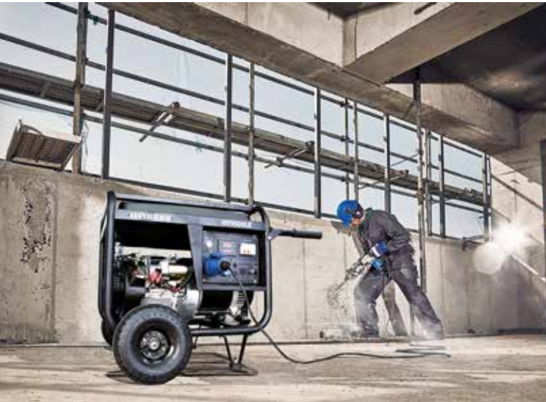
Die leistungsstarken Generatoren wie hier von Hyundai sorgen überall dort für Strom, wo keiner vorhanden ist. (Foto: epr/Ademax)
