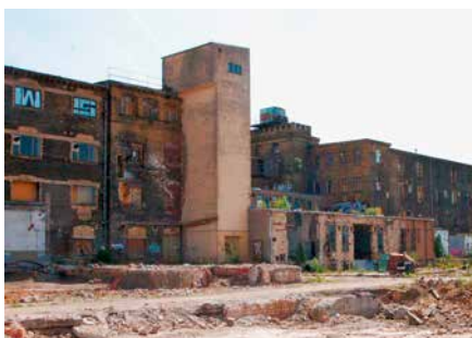
Das Gebäude der einstigen Mischerei ist kontaminiert und muss abgerissen werden
